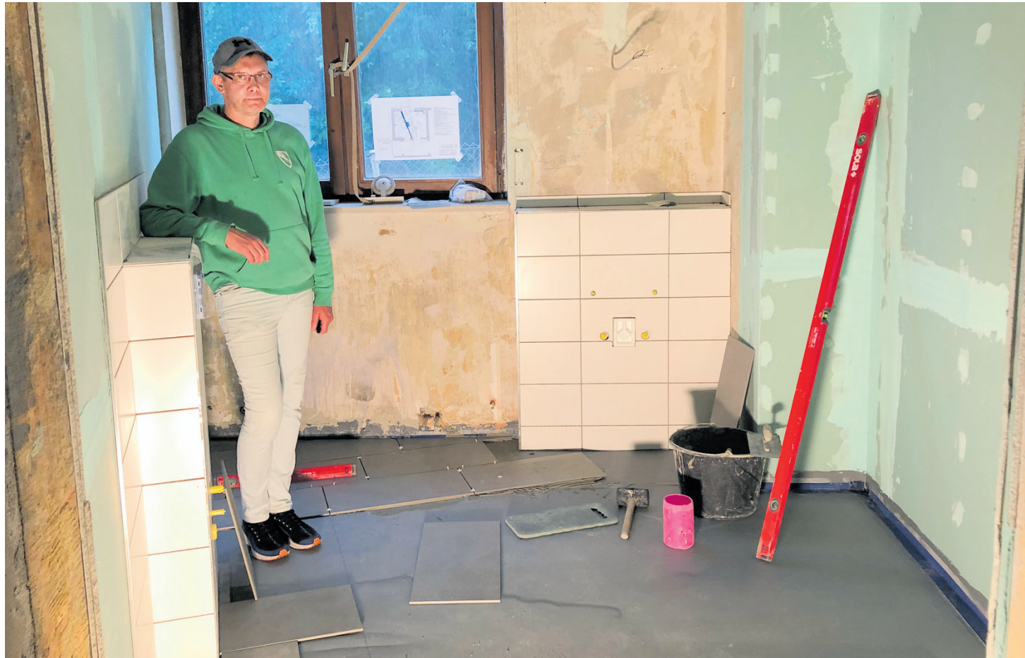
Münsters Vorstand Oliver Jakisch in der zukünftigen barrierefreien Toilette des TSVgg-Vereinsheims, die derzeit gefliest wird. Die Umbaumaßnahmen sollen Anfang Juli abgeschlossen sein. Foto: Torsten Streib
